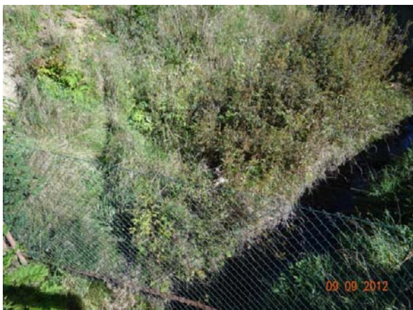
Pletivový plot přes koryto přímo nad mostem, dojde k ucpání profilu mostu.
