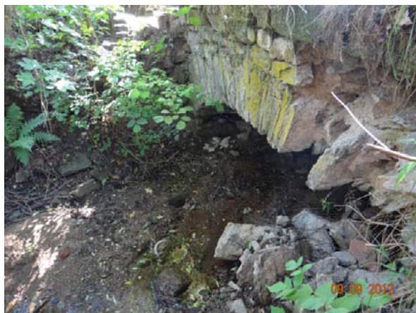
Kamenný klenbový staticky narušený most na cestě pod objektem č.p. 1.
