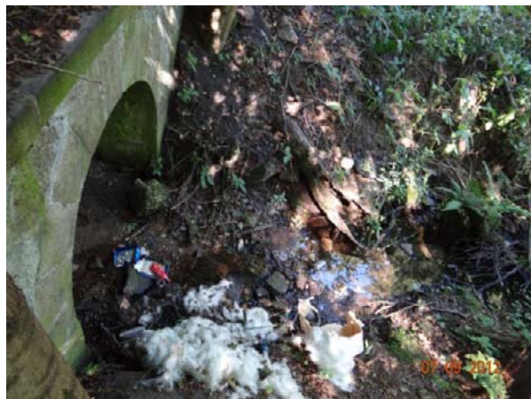
Nekapacitní profil nad Březovou - dojde k přelití komunikace.
