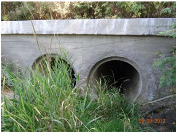
Trubní propust v tělese komunikace.
