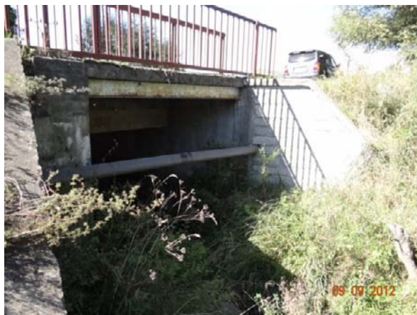
Most 198-031 s nevhodně řešeným křížením toku inženýrskými sítěmi. Dojde k záchytu splávi.
